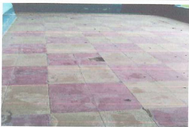
Foto 3: PISO DE CORREDOR
